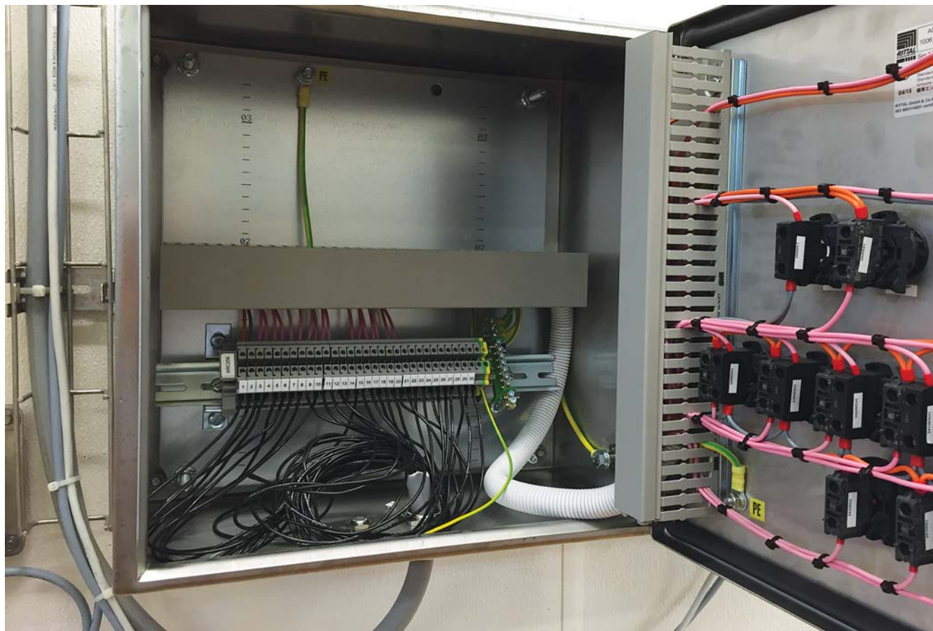
Rys. 7. Szafa sterownicza linii konwejera
