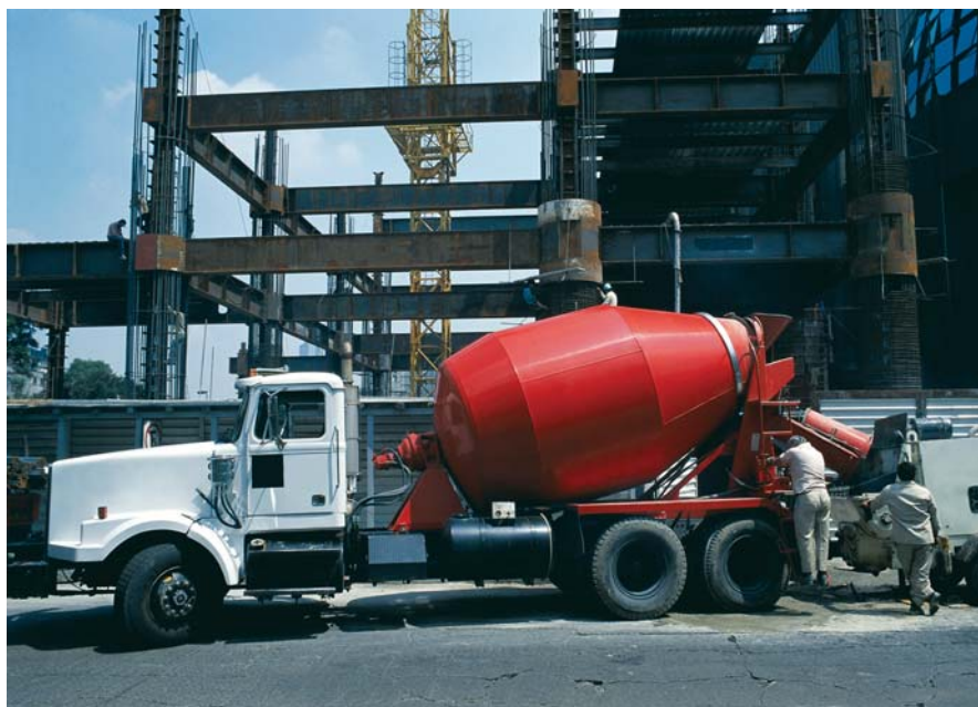
Rys. 3. Na placach budów przewody są szczególnie narażone na uszkodzenia mechaniczne
