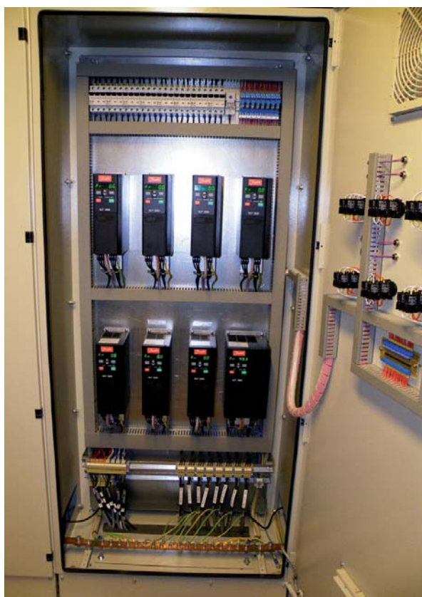
Rys. 7. Szafa sterownicza w podziemnej części fontanny
