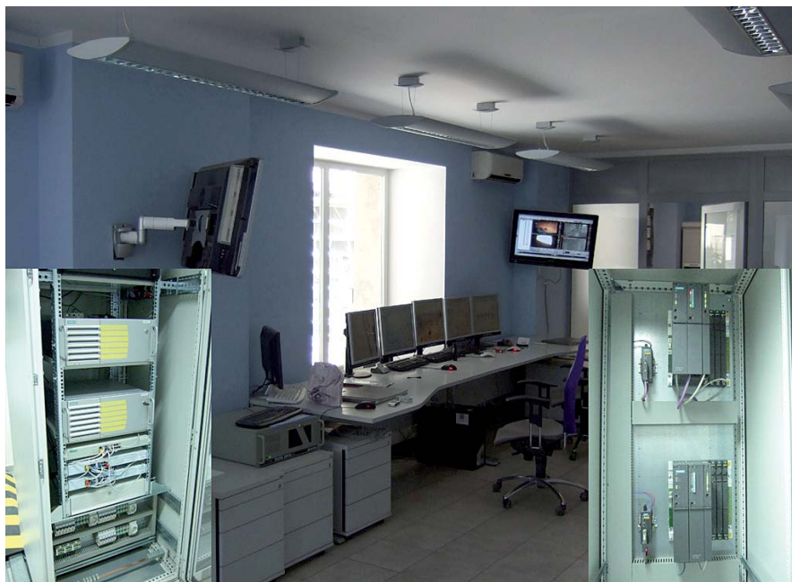
Rys. 10. Centralna sterownia, po lewej serwery procesowe, po prawej sterowniki PLC
