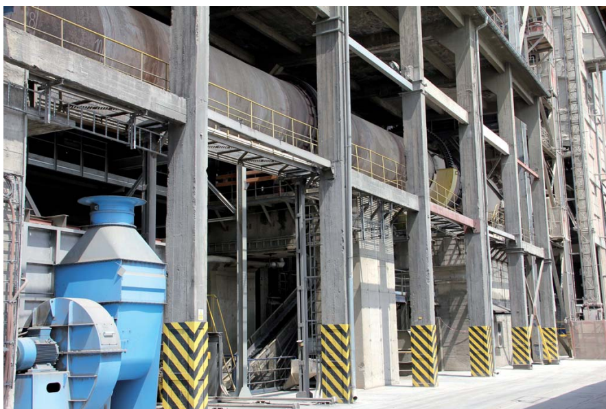
Rys. 8. Piec obrotowy w którym zachodzi proces klinkieryzacji (wypał klinkieru)
