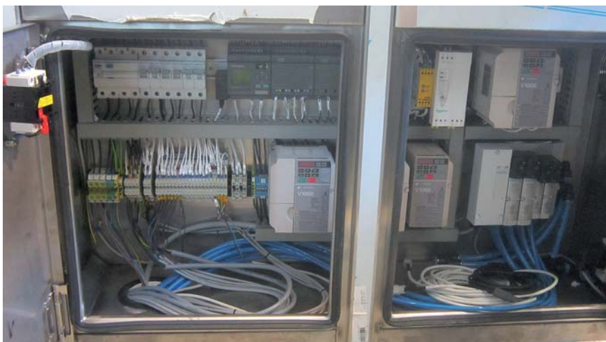
Rys. 2. Szafa zasilająco-sterująca – widoczne połączenia wykonane linkami H05V-K oraz H07V-K
