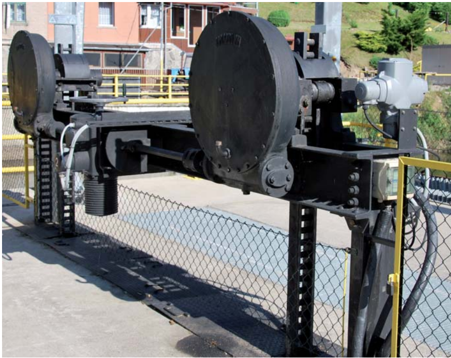
Rys. 6. Urządzenia regulujące objętość wody dopływającej do turbin
