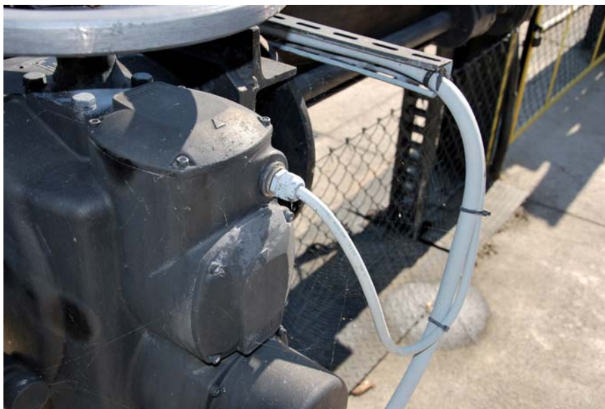
Rys. 7. Zasilanie urządzeń na zaporze piętrzącej
