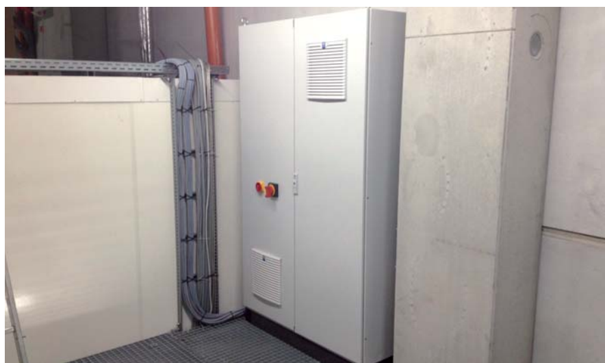
Rys. 4. Szafa sterownicza podłączona przewodami Ölflex Classic 110 i 110CY
