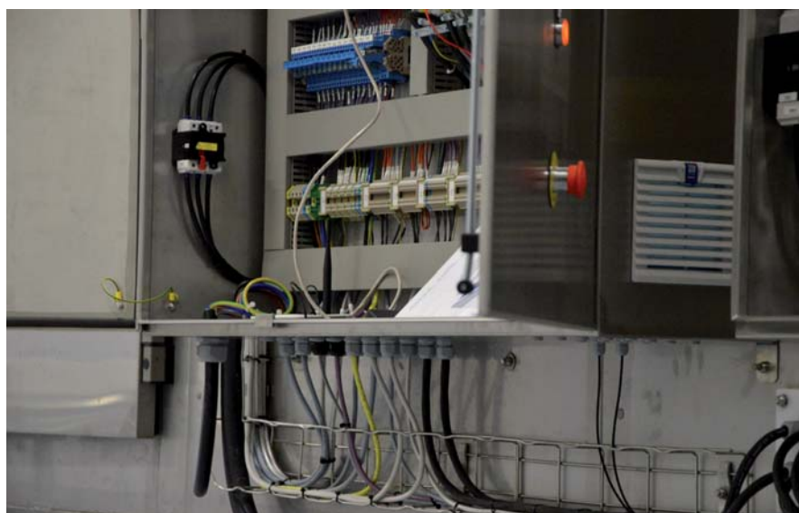
Rys. 5. Wnętrze szafy sterowniczej – przewody H05V-K i H07V-K
