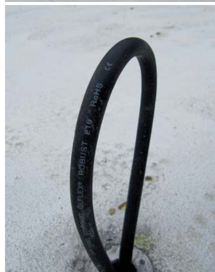
Rys. 2. W modernizacji oświetlenia szczecińskiej fontanny został wykorzystany przewód Ölflex Robust 210
