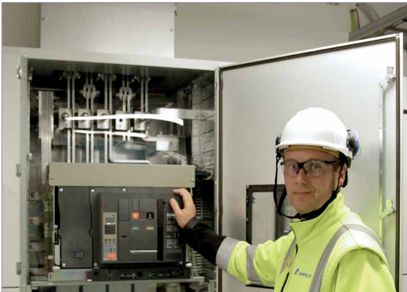
Lastensairaala- ”Koen, että Lapp Connectolla on vankka asema näissä kiskoissa Suomen markkinoilla. Asennuspalvelu erottaa Lapp Connecton alan muista toimijoista. Asennuspalvelun ja kiskojen tuleminen yhdeltä ja samalta asiantuntijalta antaa projektille lisäarvoa”, toteaa Amplit Oy:n Tekninen johtaja Tomi Alanen.
