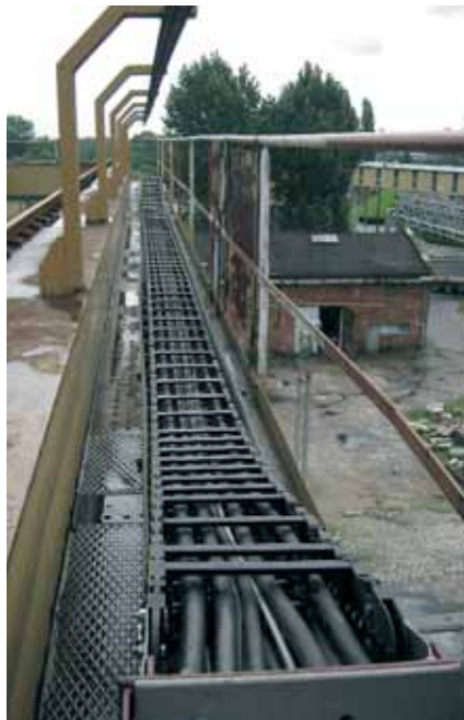
Rys. 9. Prowadnica SR326 – zasilanie i sterowanie na suwnicy
