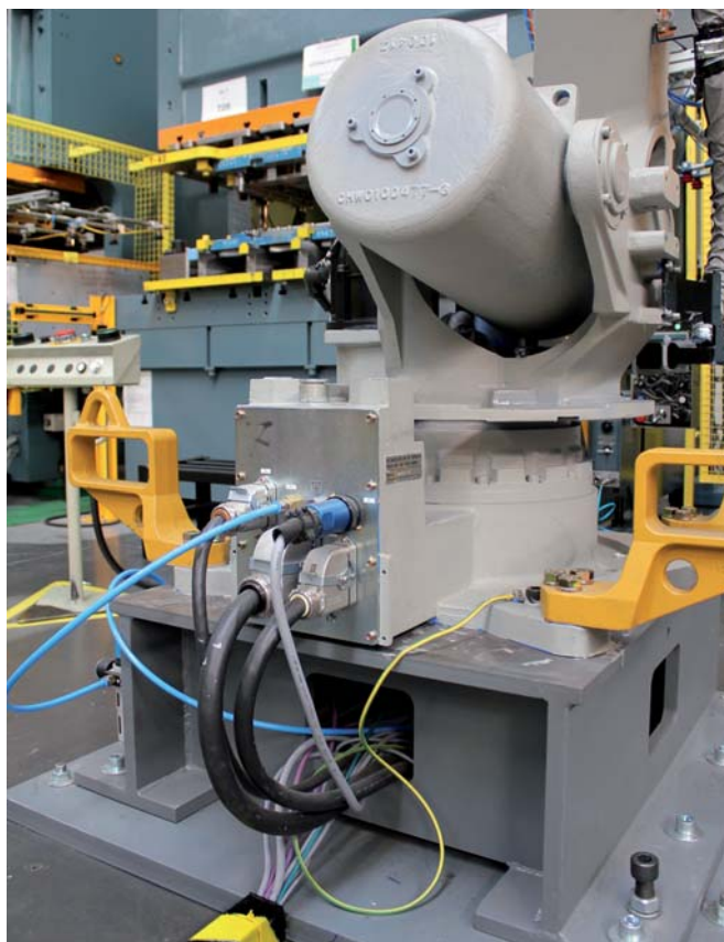
Rys. 8. Przewody Ölflex 400P oraz Unitronic bus L2/FIP zasilające i sterujące robotem
