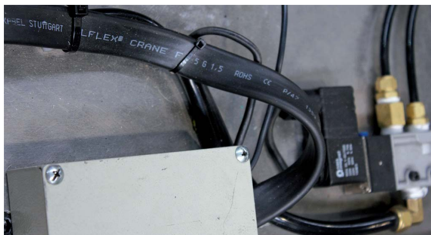
Rys. 7. Przewód Ölflex Crane F w zasilaniu napędu linii tłoczącej
