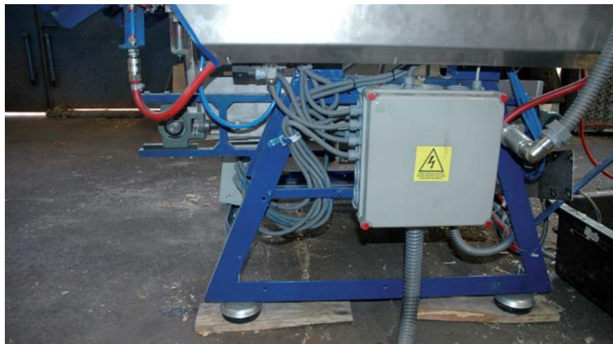
Rys. 5. Maszyna do wypiekania kubeczków typu świderok – instalacja zabezpieczona peszlami typu Silvyn EL
