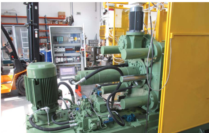
Rys. 3. Okablowanie maszyny przy wykorzystaniu przewodu Ölflex Classic 110 CY
