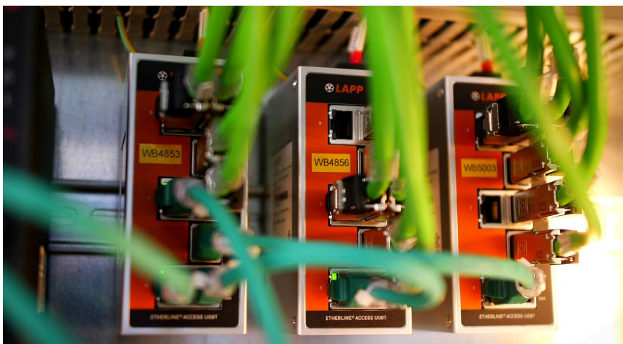
Przełączniki sieciowe Etherline Access wraz z patchcordami Lapp
