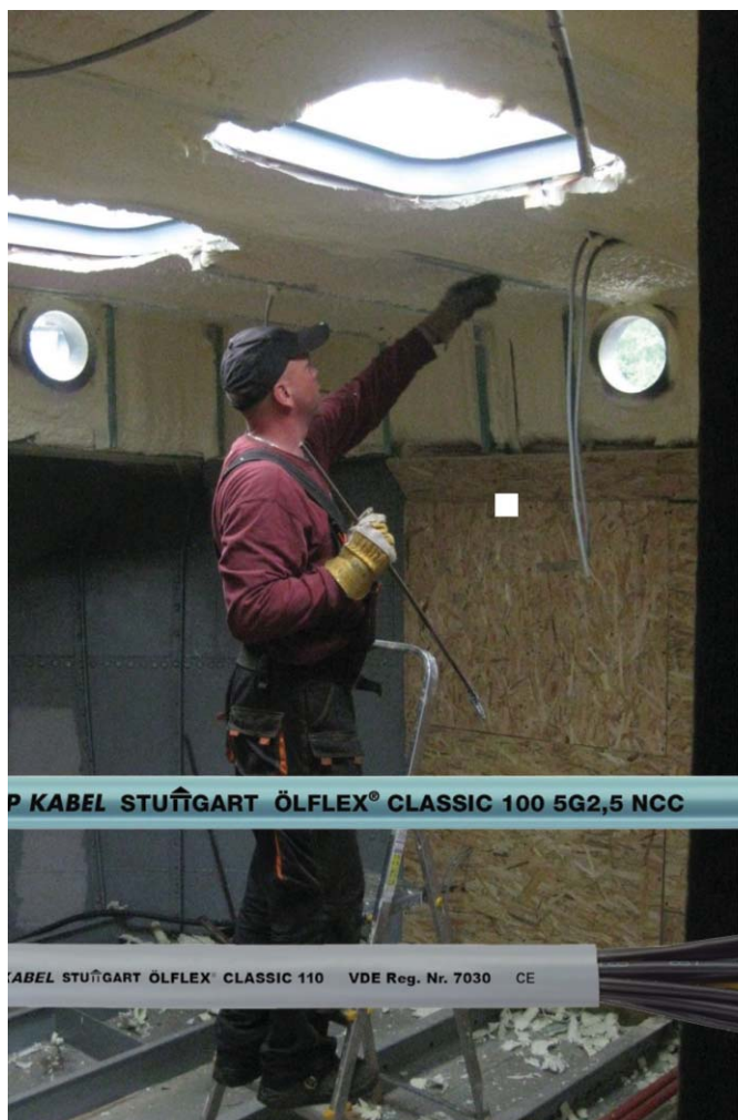
Rys. 3. Do zasilania, klimatyzacji oraz wentylacji użyto przewodów Ölflex Classic 100 i Ölflex Classic 110
