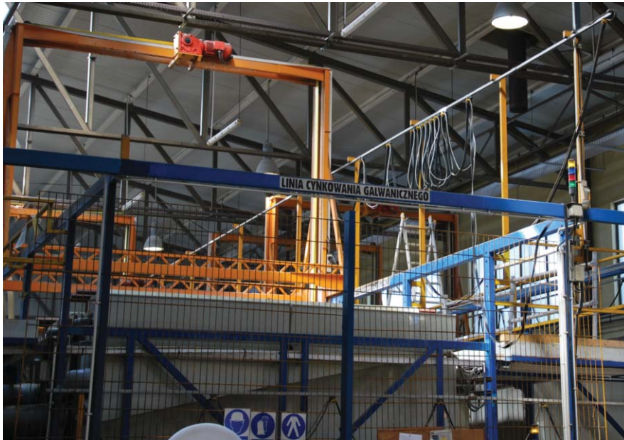
Rys. 11. Linia cynkowania galwanicznego z systemem prowadzenia kabli płaskich
