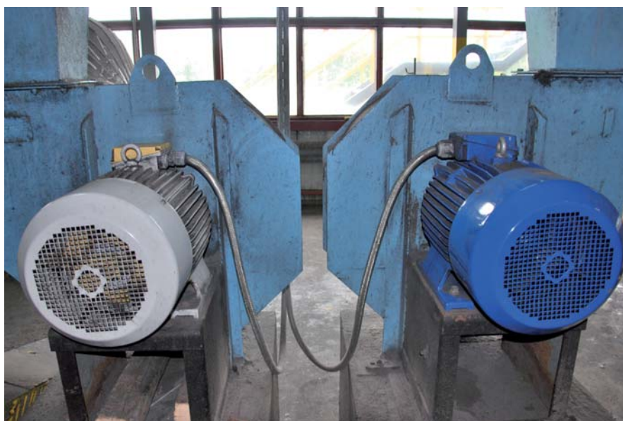
Rys. 5. Przewody Ölflex Classic 100 CY podłączone do silników elektrycznych wentylatora nadmuchu
