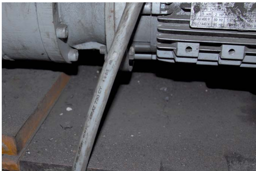
Rys. 4. Przewód Ölflex Servo 730 CY – zasilanie napędu rusztu kotła
