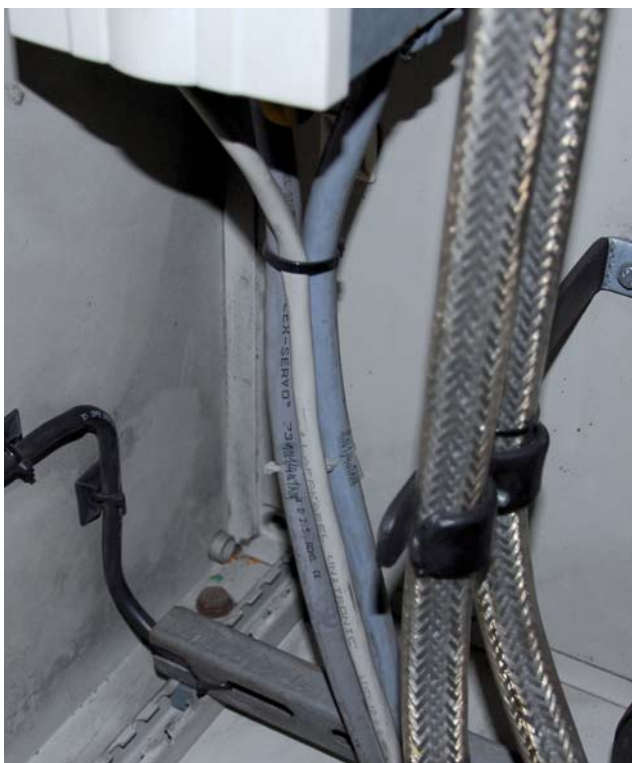
Rys. 6. Przewody Ölflex Servo 730 CY, Unitronic LiYCY, Ölflex Classic 100 CY – falownikowa szafa sterownicza
