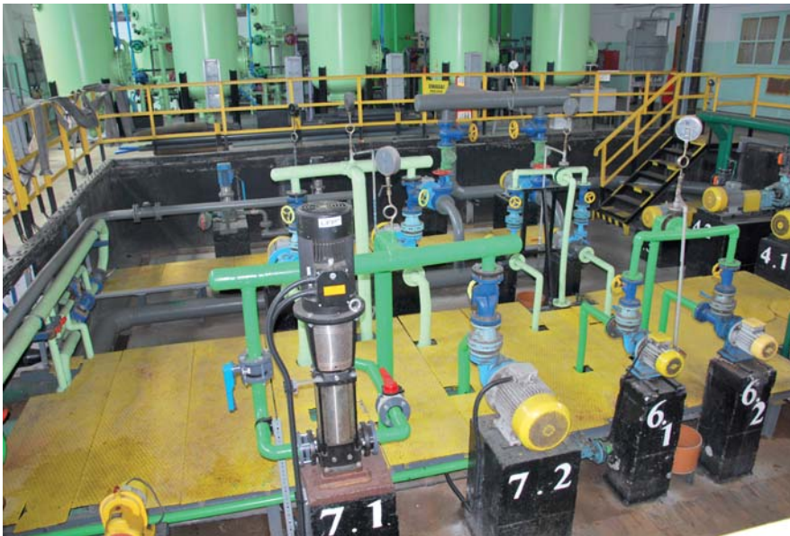
Rys. 8. Pompownia wody obiegowej
