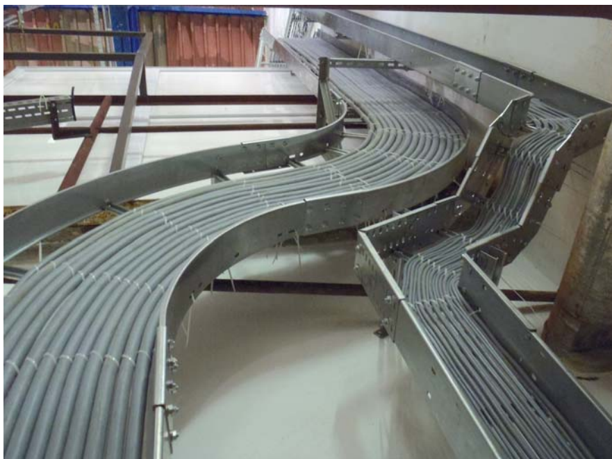
Rys. 2. Przewody Ölflex – fragment trasy kablowej w produkcyjnej
