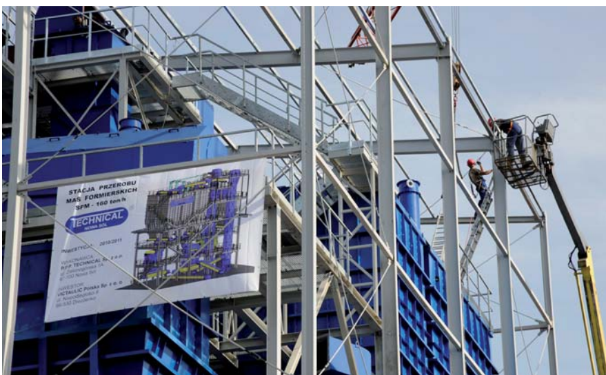
Rys. 2. Montaż stacji przerobu mas formierskich SPM-160 został zrealizowany przez firmę Technical
