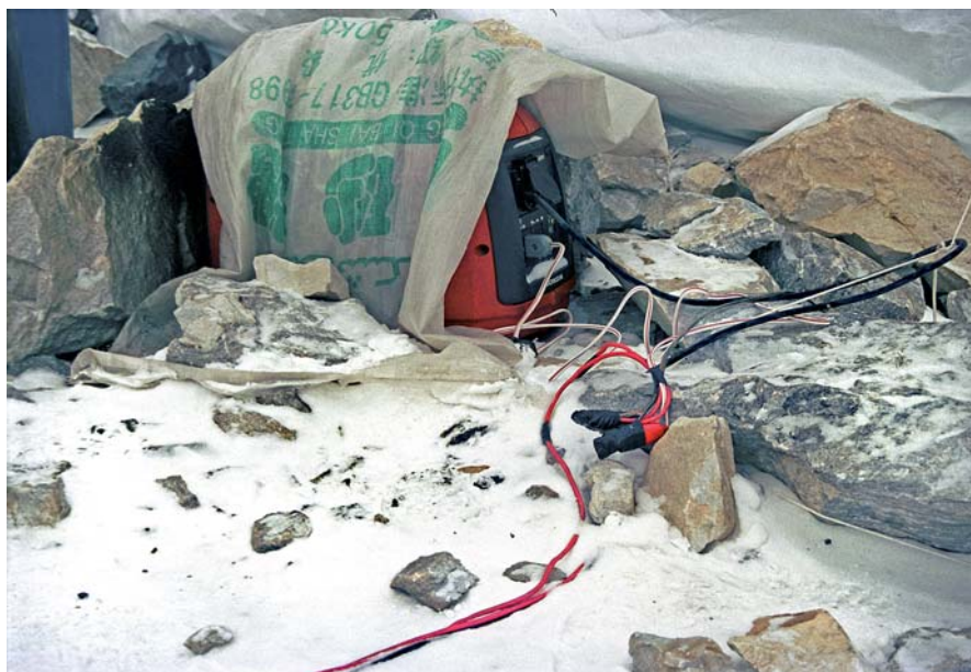
Rys. 2. Agregat prądotwórczy połączony przewodem Olflex Heat 180 EWKF 2 x 0,75 mm 2
