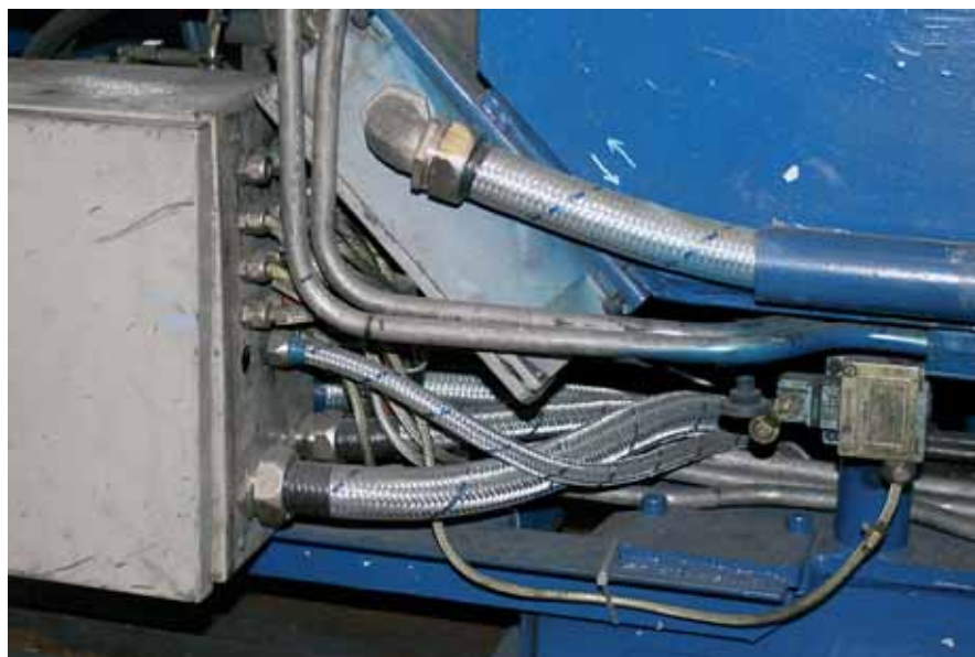
Rys. 7. Do ochrony przewodów w strefie gorącej użyto metalowych węży osłonowych Silvyn Edu-AS
