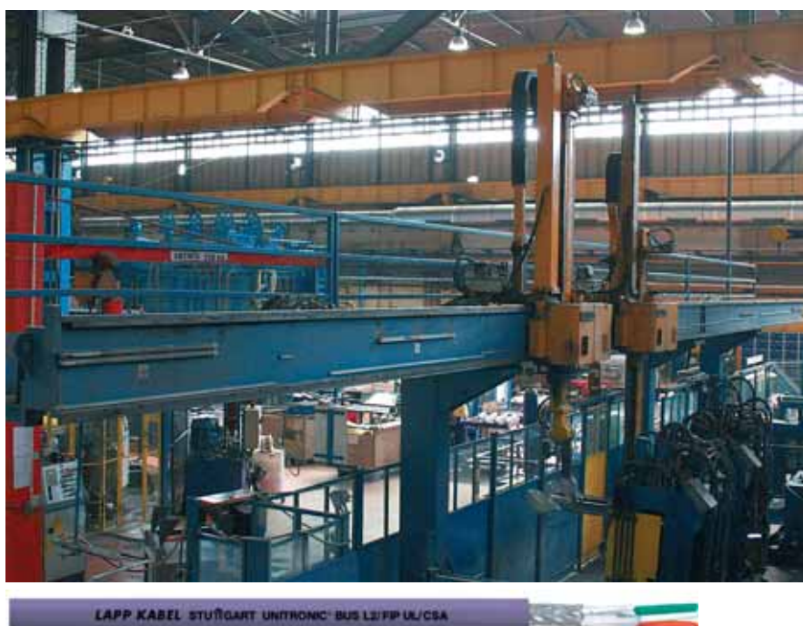
Rys. 4. System sterowania robotami pracującymi liniowo stworzono przy wykorzystaniu fioletowych przewodów Unitronic Bus
