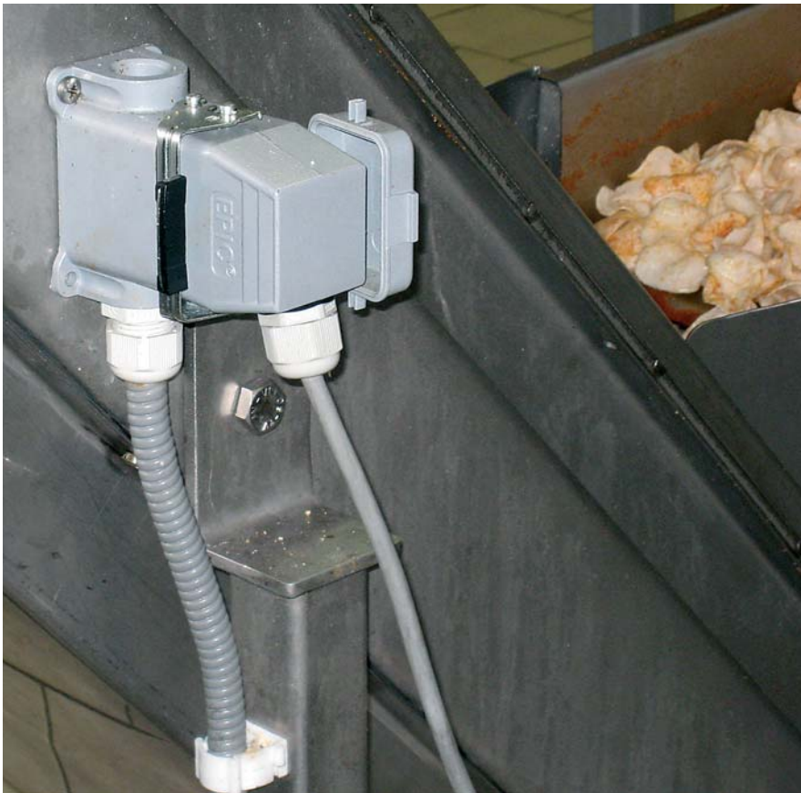
Rys. 4. Złącze Epic na smażalniku prażynek
