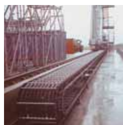
Стальная кабельная цепь типа BS3500 с несущей рамкой, аэропорт в Мюнхене (Германия)
