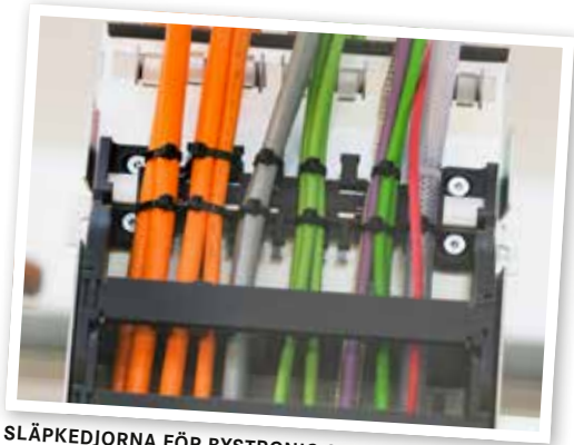
SLÄPKEDJORNA FÖR BYSTRONIC GLASS INNEHÅLLER STRÖM- OCH STYRKABLAR, BUSSKABLAR SAMT ÄVEN SLANGAR FÖR ANDRA MEDIER.
