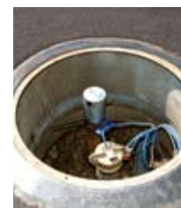
OMSLAGSBILD KABELANSLUTNING PÅ BENSINSTATION FOTO: MCD AB
